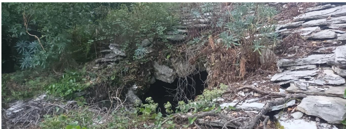
Photo 2 : toit partiellement effondré favorisant les courants d'air, une termo-hygrométrie instable, une luminosité importante et un accès aux prédateurs ce qui constitue des conditions défavorables pour l'espèce
