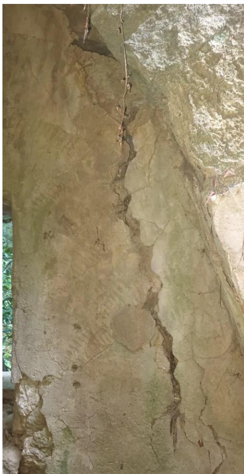
Figure 7 : Fissure intérieure. Vue sur une partie de la voûte qui sera reprise dans son ensemble
