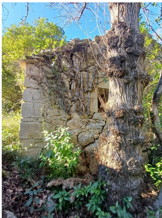
Photo 3 : vue latérale droite (est) du moulin présentant une fissure importante
